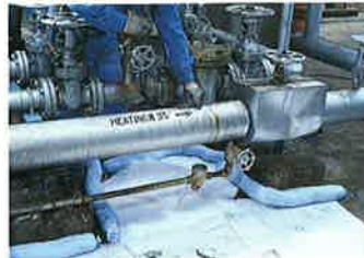
作業中の漏油に
